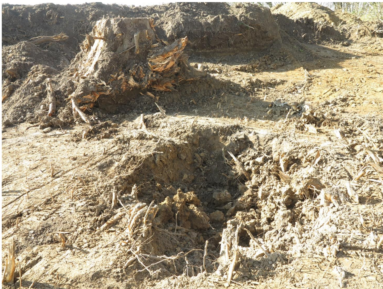
Figur 5. Ødelæggelserne efter forsøget på at fjerne to store rødder i den vestlige ende af gavlen.
