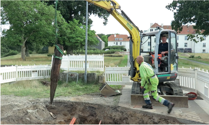
Med et vældigt 'svup' blev de 450 år gamle egestolper halet op af sumptørven under Sølundvej.
